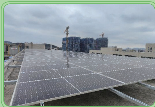
廠區光伏系統
